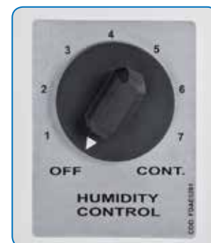
Interrupteur permettant de régler l'humidité souhaitée dans le local
